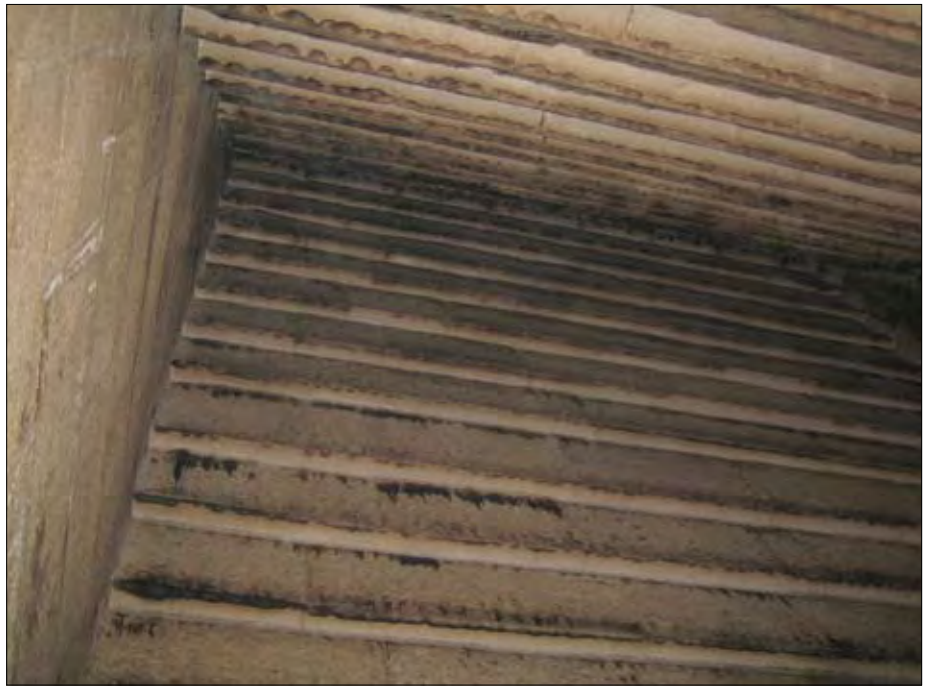
Das Kraggewölbe in der „Grabkammer“ der Roten Pyramide von Dahshur: Man sieht deutlich, dass an den Kragsteinen über eine gewisse Zeit (schmutziges) Wasser entlang gelaufen ist und seine Ablagerungen hinterließ.
