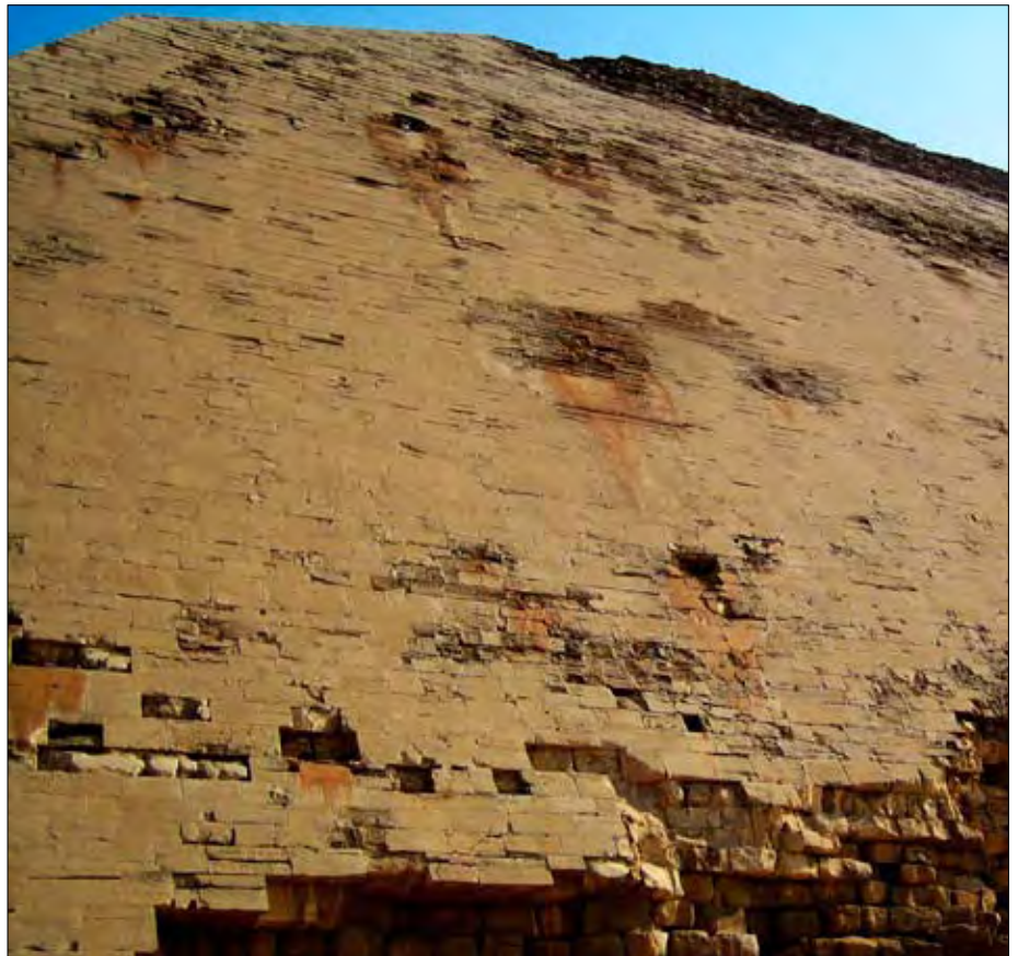
Die „Knickpyramide“ von Dahshur: An den Beschädigungen der Außenverkleidungen sieht man noch heute, wo das durch die Flutwelle in die Pyramide eingedrungene Wasser wieder abgeflossen ist.
